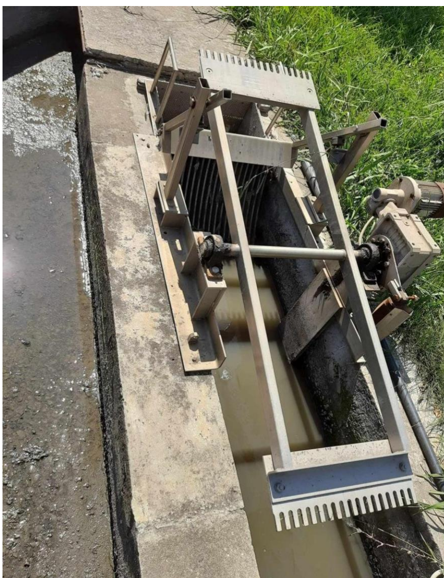
Figure 4: poste de dégrillage
