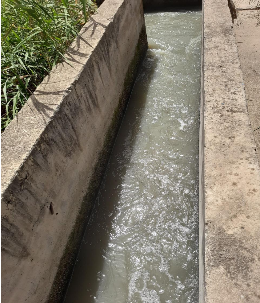
Figure 10: eau épurée à la sortie
