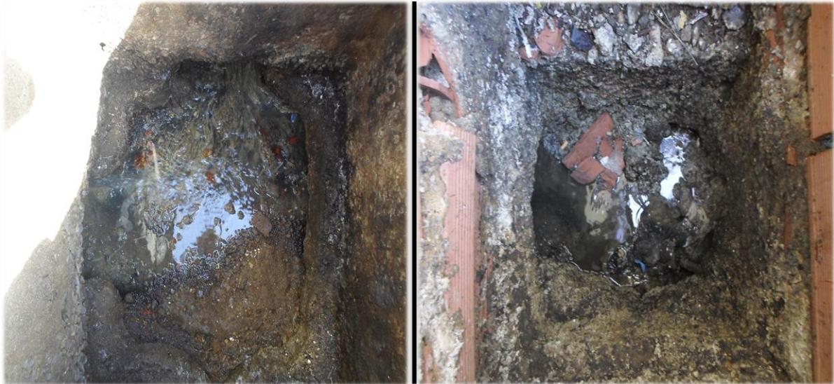
Figure II-01 : Regard en mauvais état (26-03-2016)
