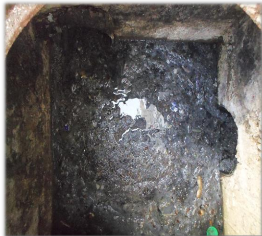
Figure II-05 : Regard bouché au niveau du cite les Annassers 1 (25-03-2016)
