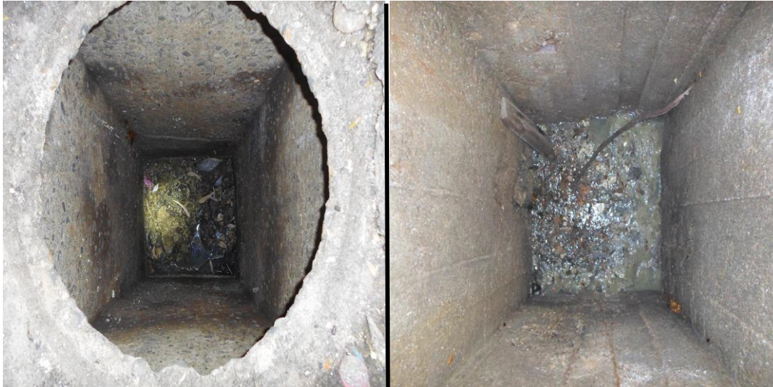
Figure II-11 : Regard avec faible écoulement au niveau du cité les Annassers 1 (27-03-2016)
