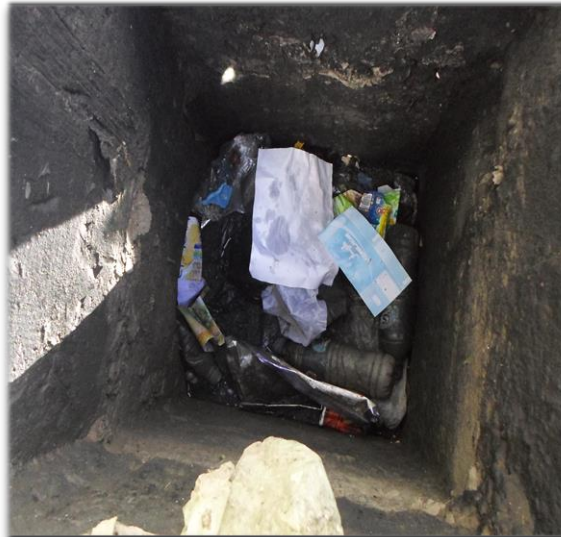
Figure II-08 : Regard colmaté pénétration des déchets (27-03-2016)
