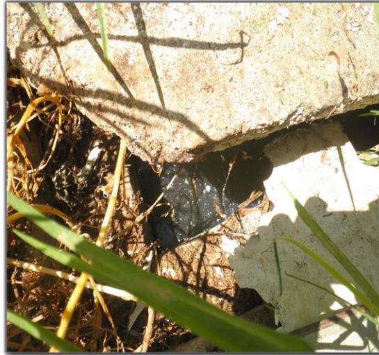
Figure II-03 : Débordement de regard au niveau du cite les Annassers 2 (01-06-2016)
