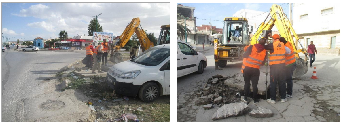
Figure V-6 : Couverture des regards avec des dalles lourdes nécessitant un engin pour les soulevés.(2020)
