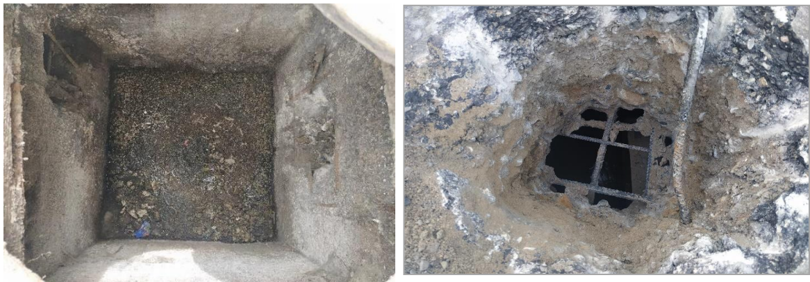
Figure V-7 : Regards encombrés (conduite amont et aval non apparentes)(2020)
