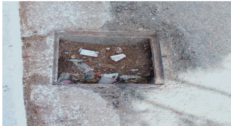
Figure II.2 : Photos d'une bouche d'égout bouchée sans tampon. (Source: l'office national d'assainissement d'Ain El Arbaa).
