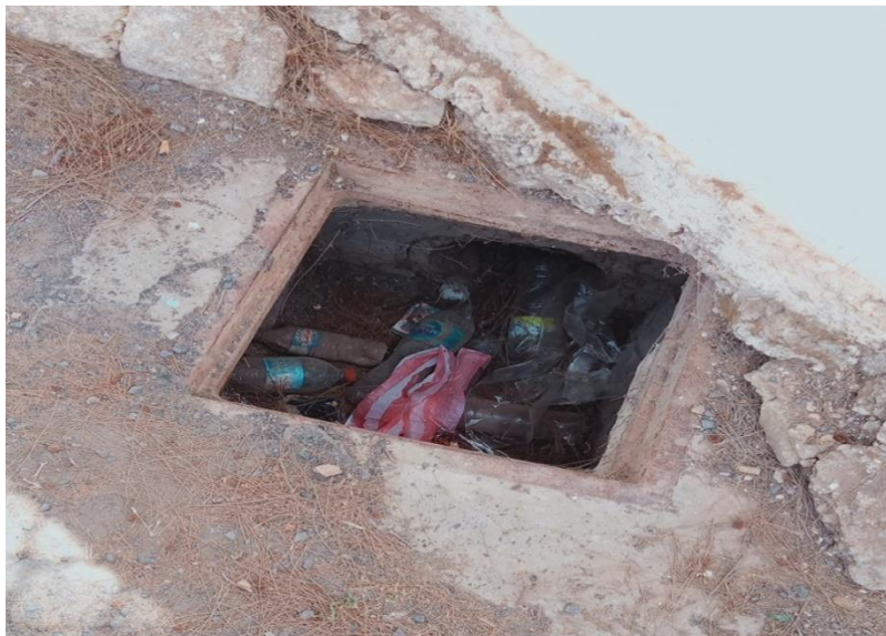
Figure II.1 : Photos d'un regard non nettoyé sans tampon regard 13 collecteur A (Source: l'office national d'assainissement d'Ain El Arbaa).
