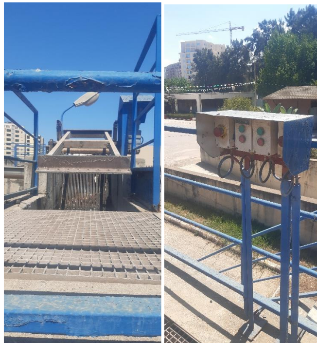
Figure 2.2 : La station d'épuration
