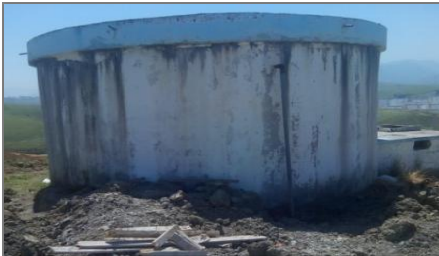
Figure I.8: Le réservoir de capacité 100m 3 (Bureau d'étude CNERU)
