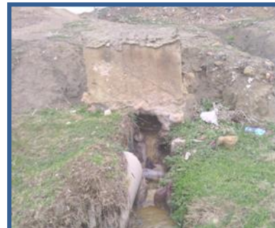
Figure 7. Regard nécessite une réhabilitation
