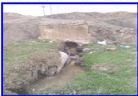
Figure 8. Regard en état vétuste
