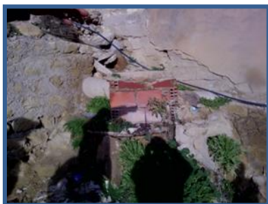
Figure 6. Regard avec collecteur traversant une habitation
