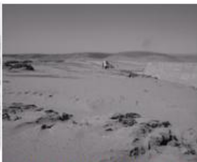
(b) L'effondrement de la retenue collinaire
