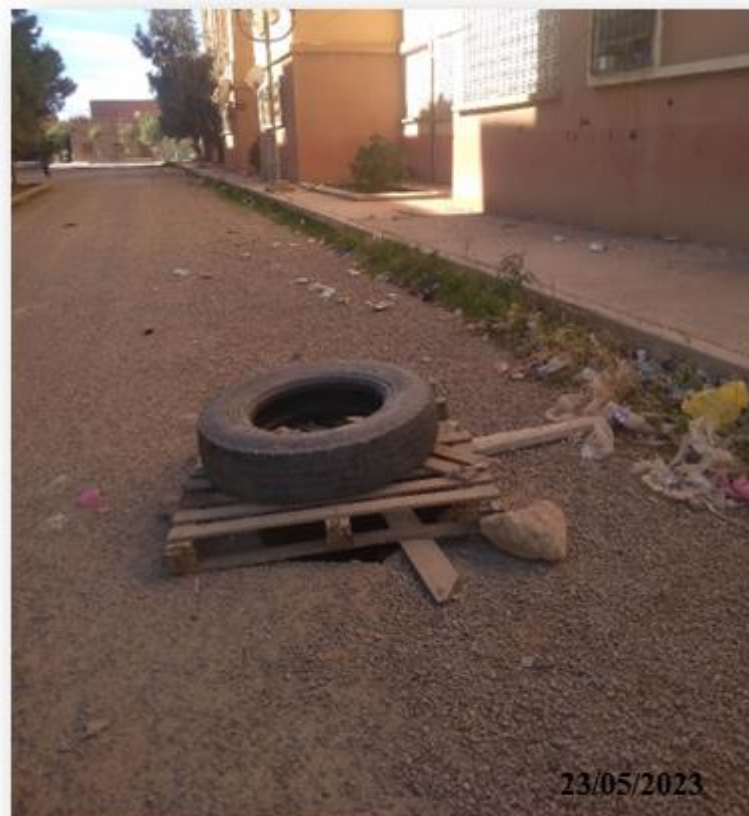
Figure II.4: Regard sans tampon (rempli de gravats)
