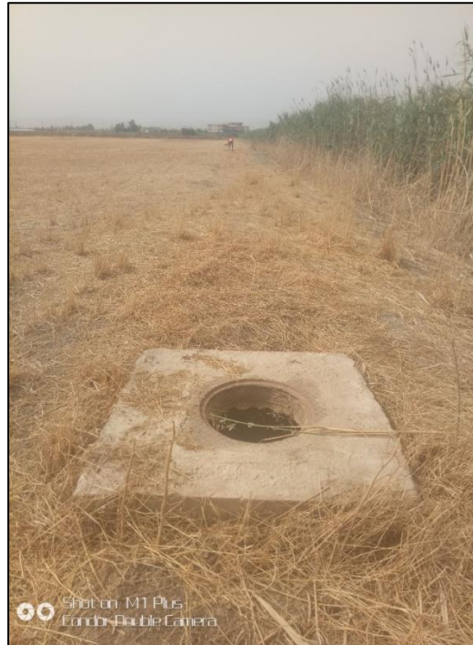
Figure III.3 Manque du tampon.
