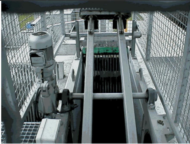
Figure 15 : le dégrilleur courbe
