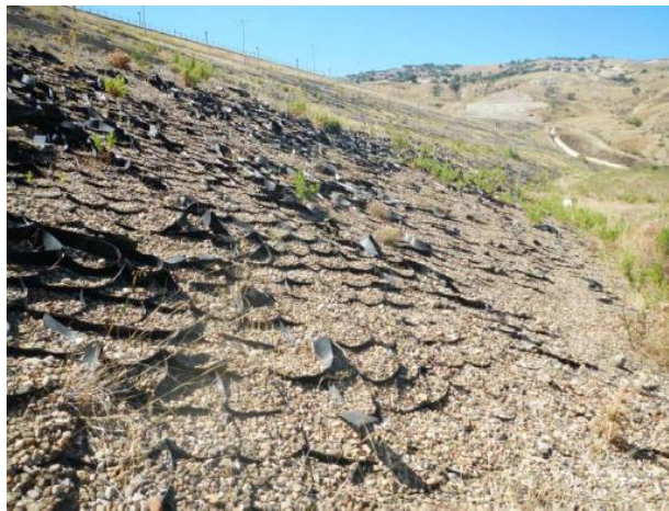
Figure II. 3: Vue du parement aval du barrage et dégradation des géo-cellules (ISL, 2015)
