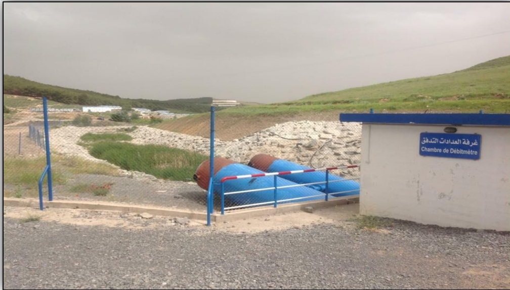
Figure III.3 Conduites de distribution pour l'irrigation (Source: O.N.I.D).
