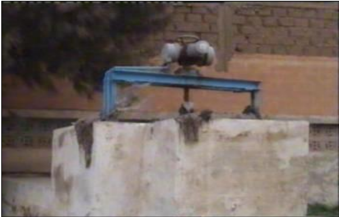
Figure II.5 : Déversoir d'orage et vanne automatique
