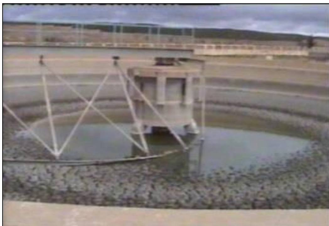
Figure II.10 : Décanteur secondaire n°1
