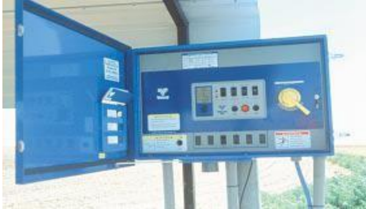
Figure 35 : centrale de commandes.
