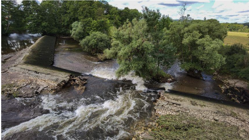
Figure 7 : Rupture d'une digue d'un barrage à Conflandey(France).
