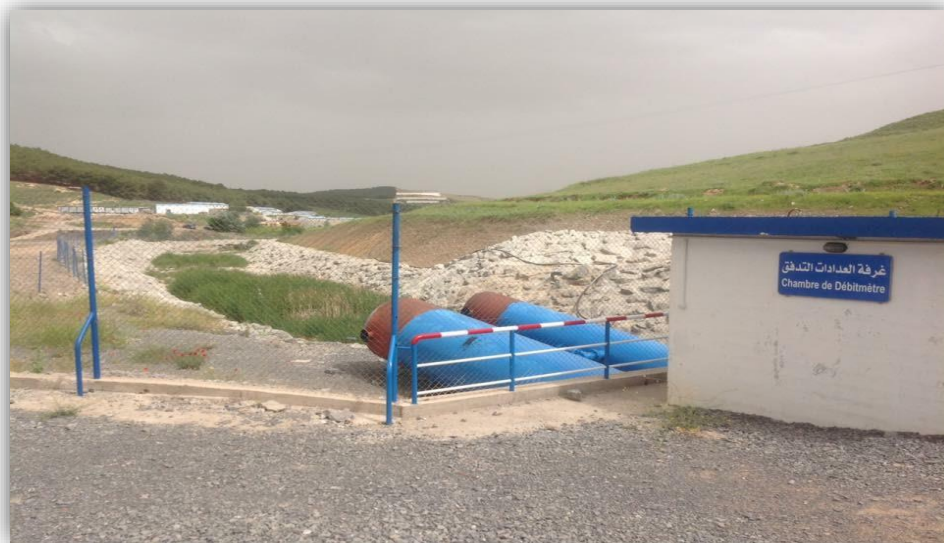
Figure III. 2: Conduites de distribution pour l'irrigation.
