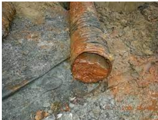
Figure 29 Le colmatage des drains
