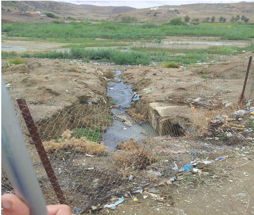
Figure II. 7: Le rejet d'assainissement directement vers le barrage
